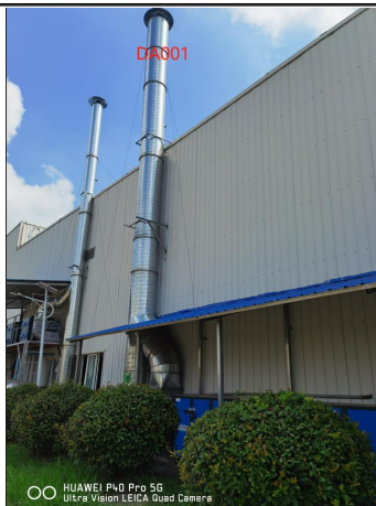
15 米高排气筒 DA001
