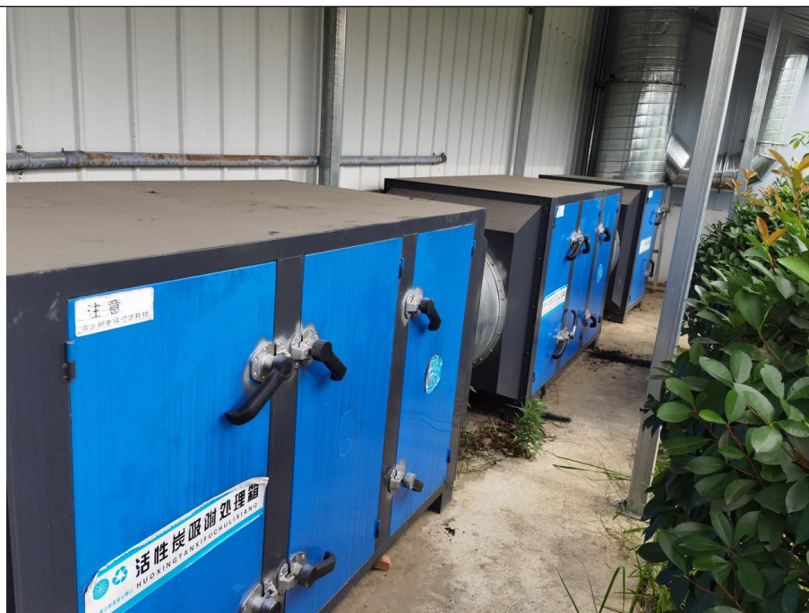
干式过滤器+二级活性炭吸附装置
